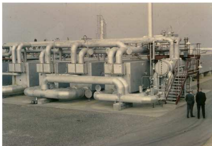
Figura 10 – Planta MSF de 36 estágios em Point Loma, Califórnia.
