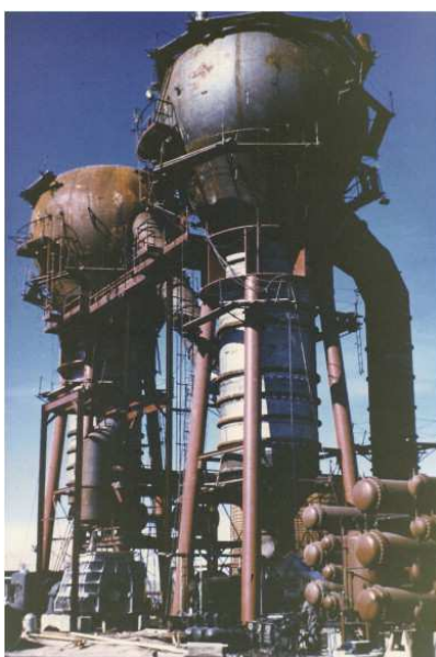
Figura 14 – A planta de destilação por compressão de vapor em Roswell, Novo México, durante a construção.
