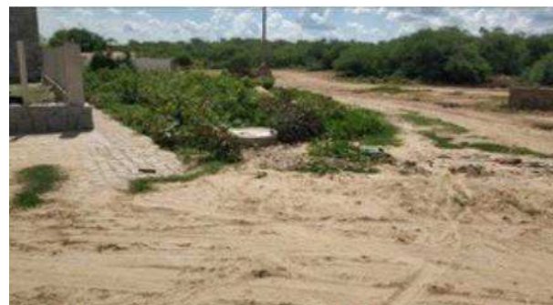
Figura 3.- (SJC2) Caixa de coleta de esgoto
