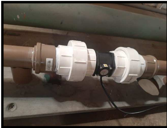
Figura 11 – Sensor instalado na tubulação
