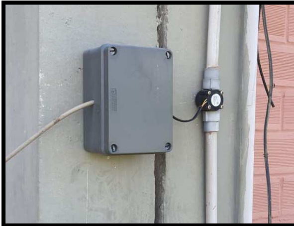
Figura 20 – Micromedidor instalado no bloco CR
