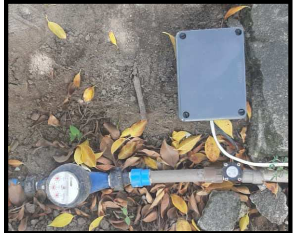
Figura 21 – Micromedidor instalado no bloco CQ
