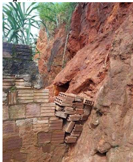
Figura 5 – muro de arrimo ineficaz
