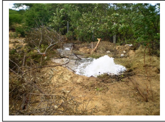
Foto 4 – Vazamento na Adutora
