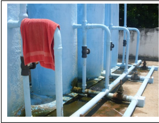
Foto 3 – Vazamento na tubulação numa ETA
