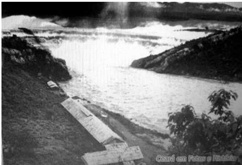
Foto 1: 26 de março de 1960. Arrombamento do açúde de Orós quando ainda estava em construção.
