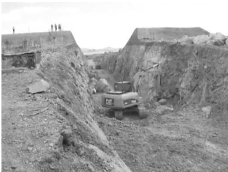
Foto 9: Rebaixamento do sangradouro da barragem de Camalaú para a passagem das águas da transposição do Rio São Francisco.
