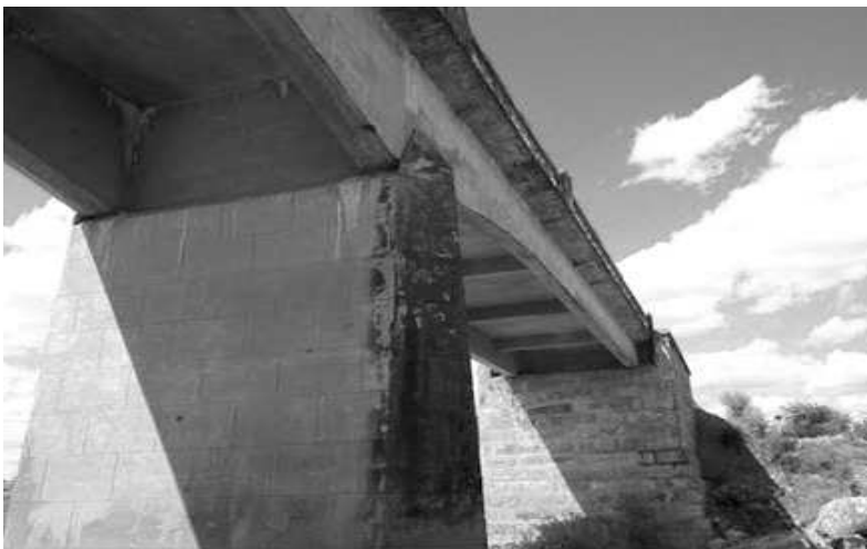
Foto 2: Exemplo de ponte com pilares maciços, dificultando a passagem da água. Fonte: Domínio Público.
