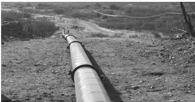
Foto 2: Adutora de engate rápido do açude de Sumé à estação de tratamento do bairro do Mandacaru – Sumé. Fonte: acervo particular do autor.
