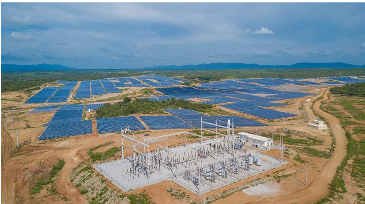
Figura 4: Sistema de Geração Centralizada de Energia Solar Fotovoltaica na cidade de Coremas – PB.
