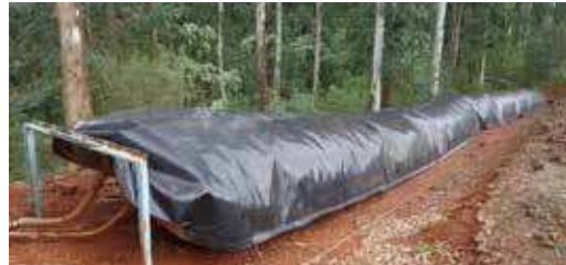
FOTO 26 | Balão pulmão com depósito de biogás, pré-gerador.
