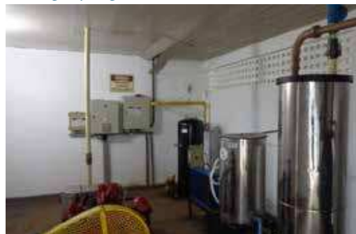
FOTO 22 | Conjunto de filtragem de gás sulfídrico do biogás, pré-gerador.
