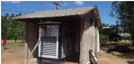
FOTO 21 | Motor gerando energia com biogás. Motor enclausurado e com abafador para reduzir a emissão de ruídos.
