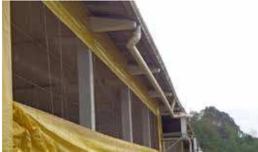
FOTO 01 | Sistema de captação da água da chuva instalado no telhado de uma granja de suínos.
