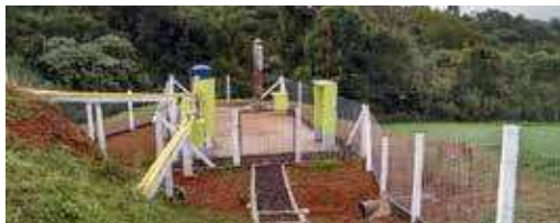
FOTO 25 | Sistema de regulação da pressão do biogás dentro do biodigestor que utiliza água como controle de nível e queimador (flare) do excedente do biogás.
