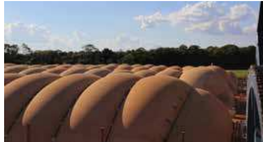
FOTO 13 | Uma série de biodigestores em pleno funcionamento.
