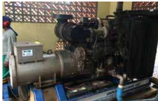
FOTO 14 | Gerador de energia elétrica a biogás.
