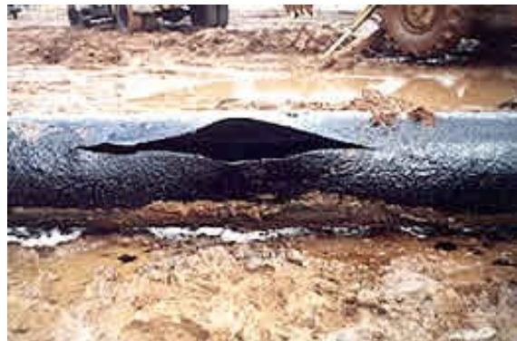
Figura 2 – Oleoduto rompido por corrosão em Campinas-SP(CETESB).
