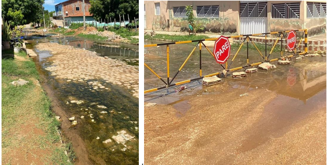
Figura 15 - Ruas interditada após vazamento de rede de esgoto doméstica no bairro Tancredo Neves em Catolé do Rocha-PB
