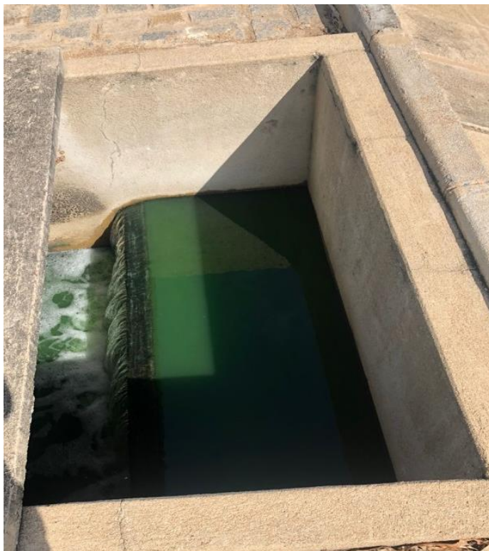
Figura 10 - Saída do efluente tratado da lagoa facultativa na ETE Catolé do Rocha-PB.
