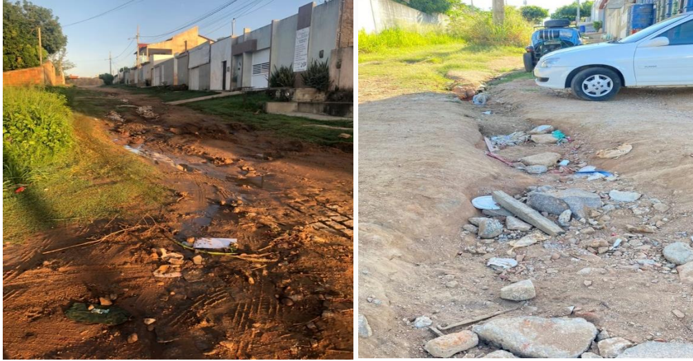
Figura 27 - Ruas afetadas por erosão devido à falta de drenagem e manejo de águas pluviais.
