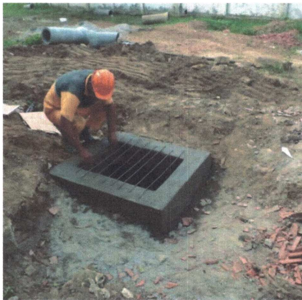
Figura 13 - Caixa de Inspeção
