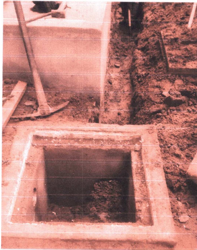
Figura 22 – Caixa de inspeção de apartamento
