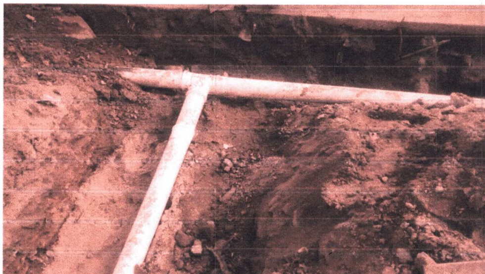
Figura 24 – Tubulação de esgotamento sanitário
