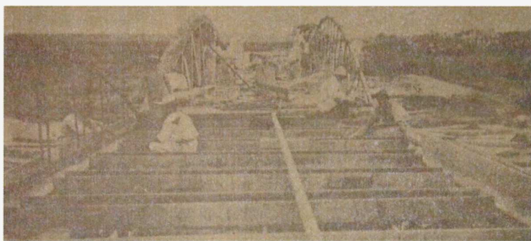
Fotografia 01: PONTE DE TAPEROÁ (1925). Aspectos do trabalho de armação da ossatura metálica e das formas de madeira para receber a argamassa de cimento. Fonte: Jornal A UNIÃO , 31 maio 1925.
