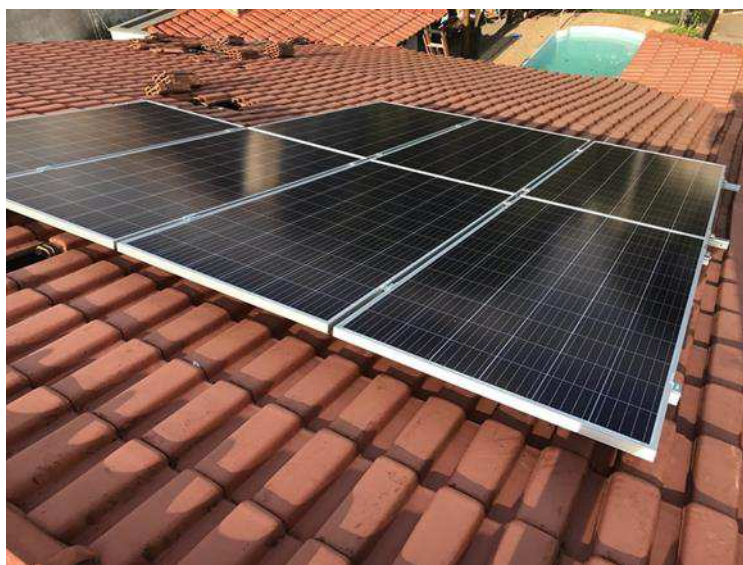
Figura 9. Placas de energia solar. Fonte: Cogera Energia (2018).
