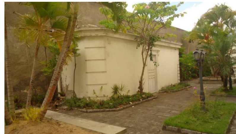
FIGURA 3: ESTRUTURA QUE SERVIU DE BANHEIRO PARA O GRUPO ESCOLAR SOLON DE LUCENA NO JARDIM, LOCALIZADO AO LADO DIREITO DO PRÉDIO
