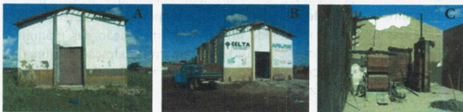
Figura 11: Prédio e máquinas de 50 serras e prensa da miniusina de algodão de Paulistana, PI: A) Antes do Incêndio e B,C) Após incêndio em 2010 com o prédio lotado de algodão e as máquinas danificadas (descarcoador e prensa hidráulica). Fotos de Vicente de Paula Queiroga
