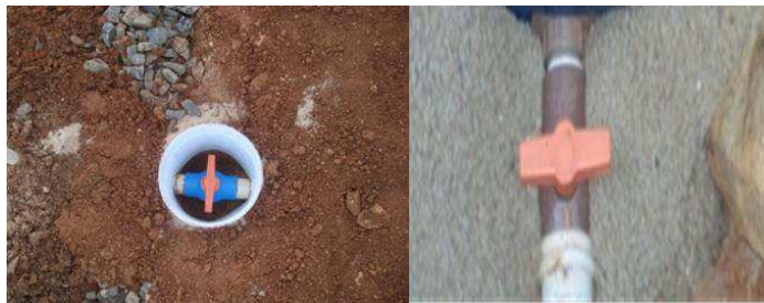
Figura 8. Registro próximo a caixa d'água e a tubulação que liga ao tanque.
