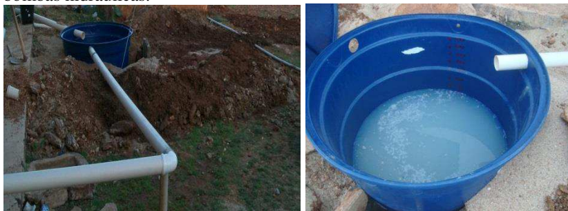
Figura 7. Caixa d'água onde será armazenada a água residuária para os tanques.
