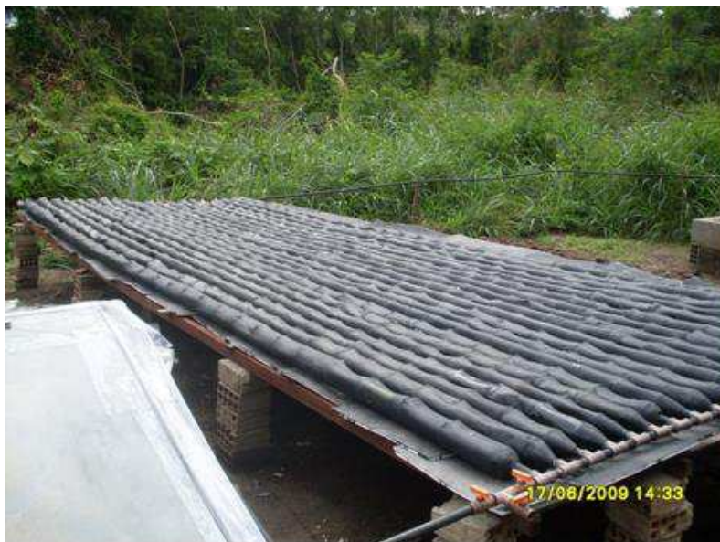
Figura 5. Coletor solar utilizado no sistema de pré-aquecimento de água.
