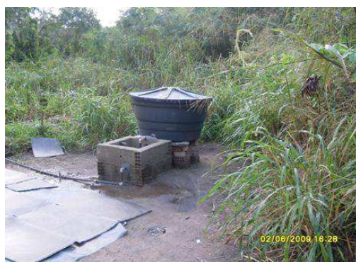
Figura 3. Caixa de abastecimento.
