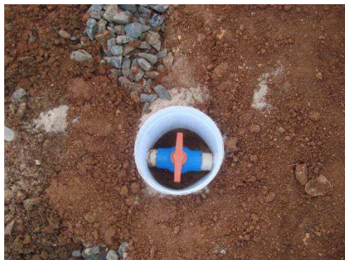
Figura 8. Registro próximo a caixa d'água a tubulação que liga ao tanque.
