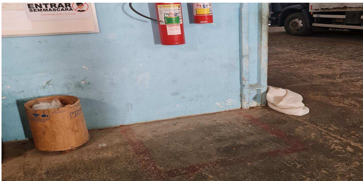
Figura 23 – Sinalização desgastada de equipamentos contra incêndios.
