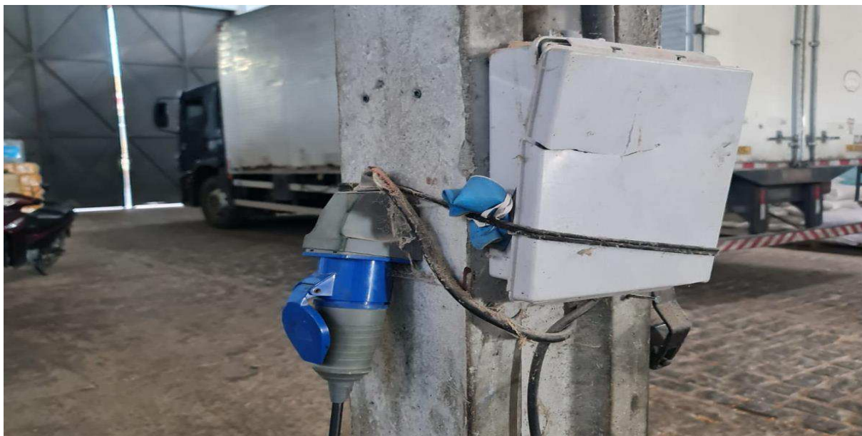
Figura 14 – Quadro de distribuição eletrônica danificado.
