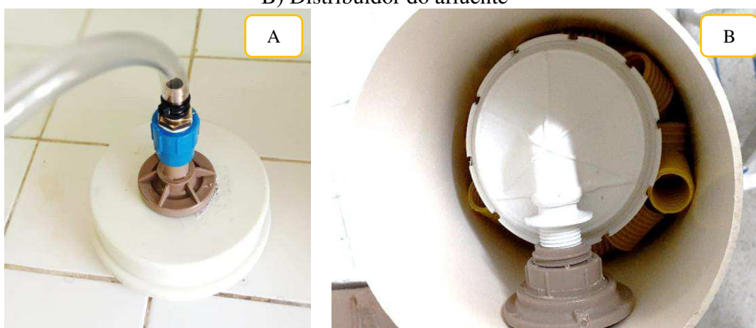
Figura 27 – Extremidade superior da torre: A) Conexões para o recolhimento do gás amônia; B) Distribuidor do afluente
