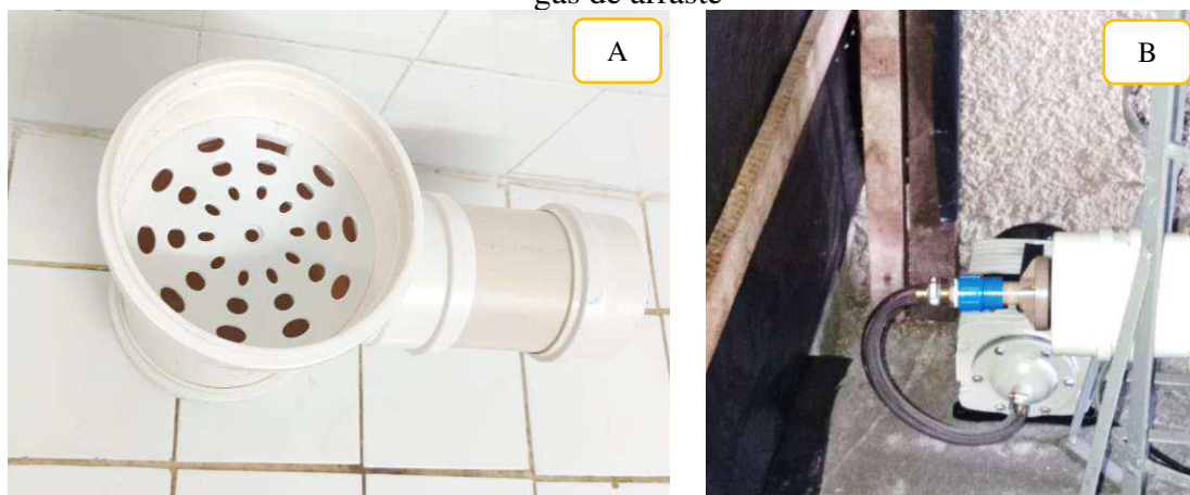
Figura 28 – Tê sanitário implantado na torre de air stripping : A) Fundo falso; B) Entrada do gás de arraste
