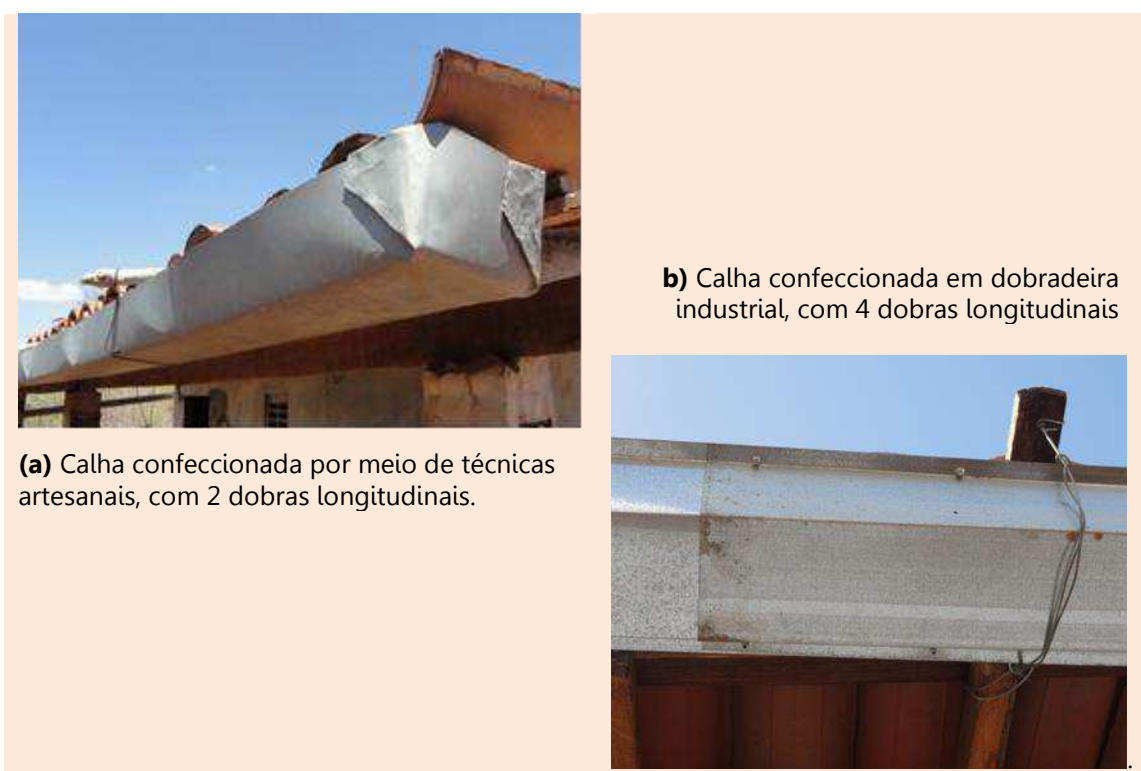
Figura 26 – Diferença de acabamento entre uma calha de chapa galvanizada dobrada artesanalmente e outra dobrada por processo industrial.
