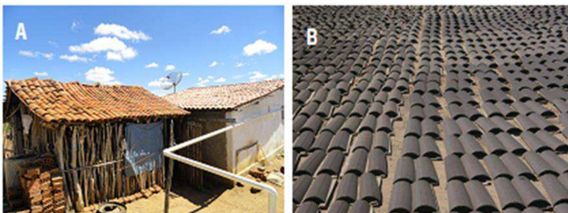
Figura 6 - Residências no SAB cobertas com telhas cerâmicas coloniais (A); e terreiro de uma olaria no Nordeste, com telhas a secar (B).
