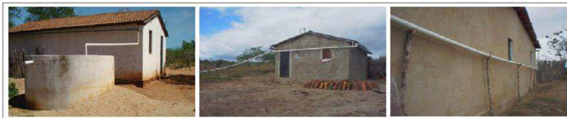
Figura 16 • Condutores suspensos, fixados por meio de suportes improvisados.
