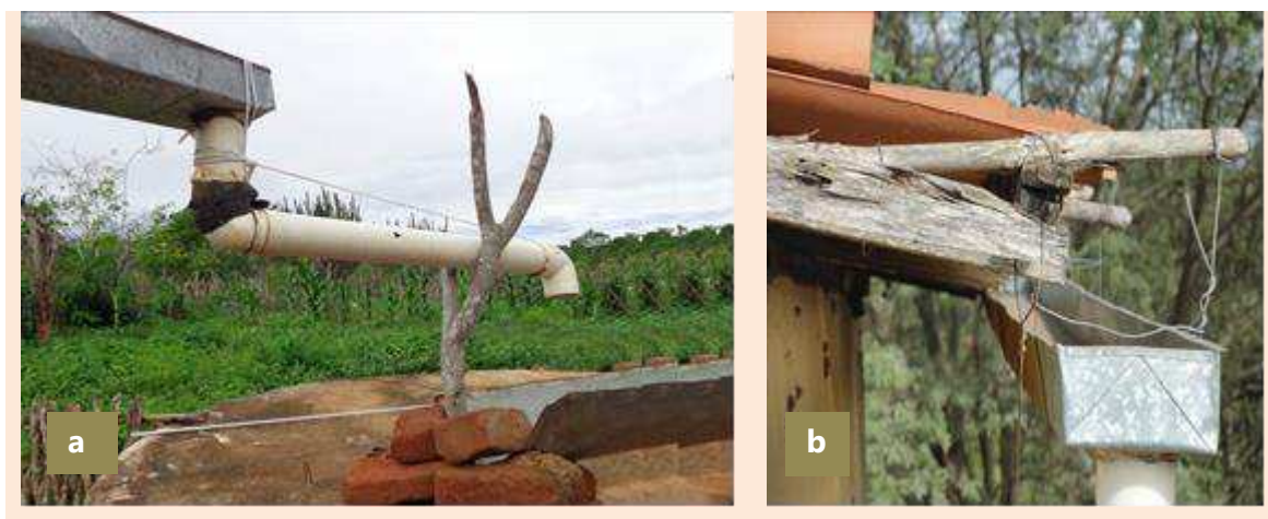
Figura 28 (a) e (b) - Improvisação de suportes de calhas e condutores com materiais inadequados
