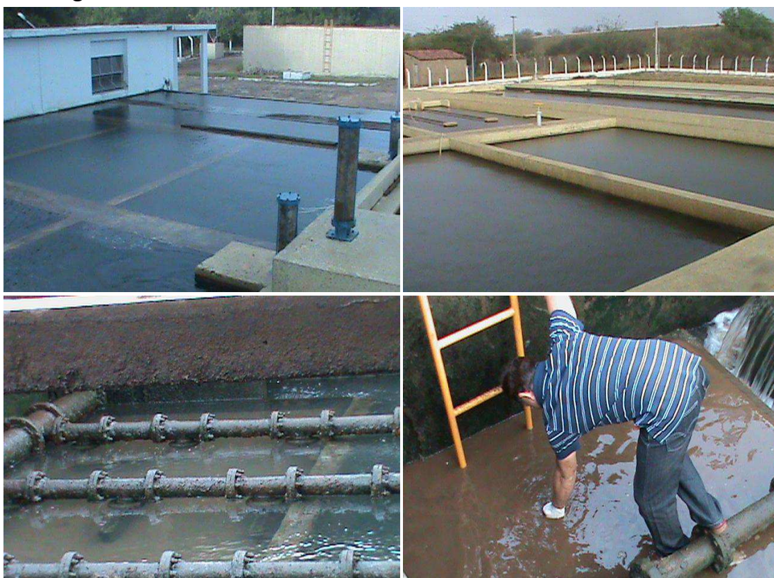
Figura 6 - ETA de Jatobá.
