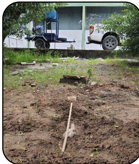
Figura 41 - Dia 11/07/2022 após conserto do vazamento
