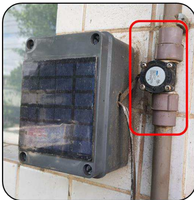
Figura 20 - Sensor de fluxo instalado na tubulação
