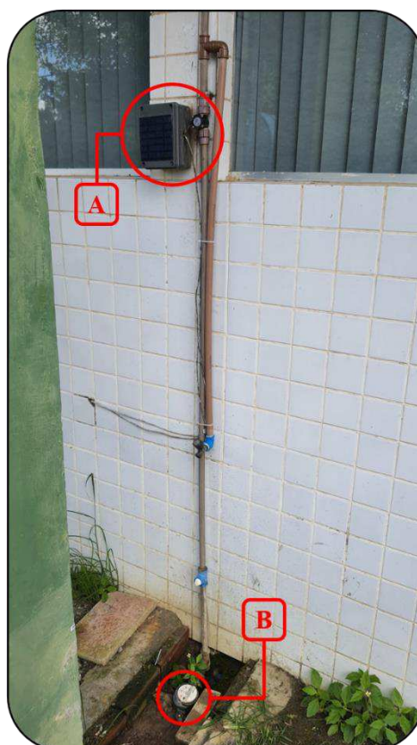
Figura 9 - Instalação do Hidrômetro IoT em série com o hidrômetro convencional
