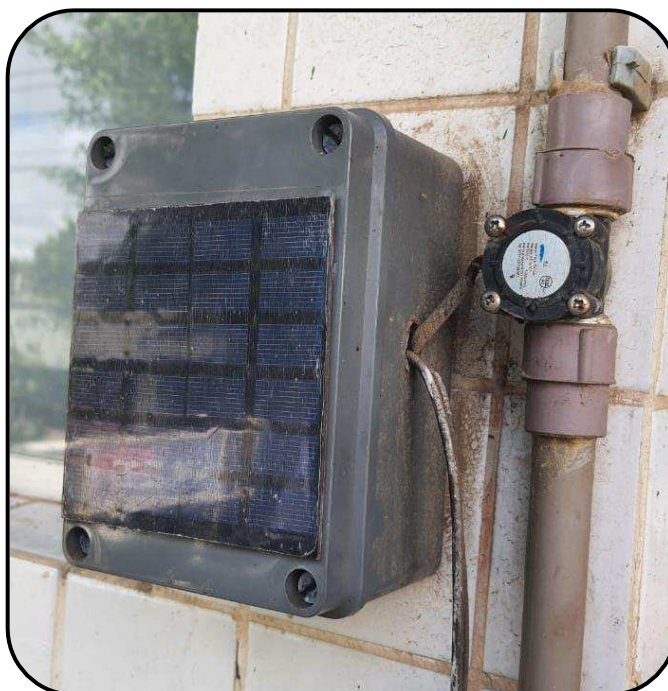
Figura 7 - Instalação do Hidrômetro IoT na tubulação principal do Laboratório de Engenharia de Pavimentos e Geotecnia (LEP)
