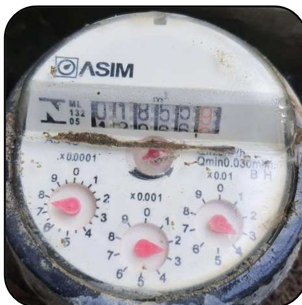
Figura 8 - Hidrômetro analógico do Laboratório de Engenharia de Pavimentos e Geotecnia (LEP)
