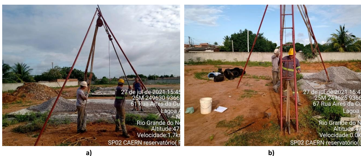
Figura 17. Execução de sondagem SPT, para projeto de construção de reservatório da CAERN, no Município de Natal-RN
