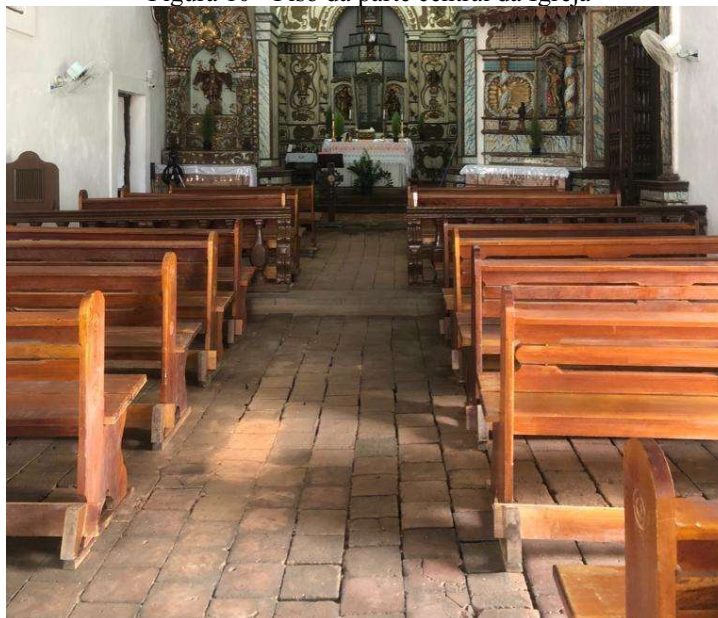
Figura 10 - Piso da parte central da Igreja
