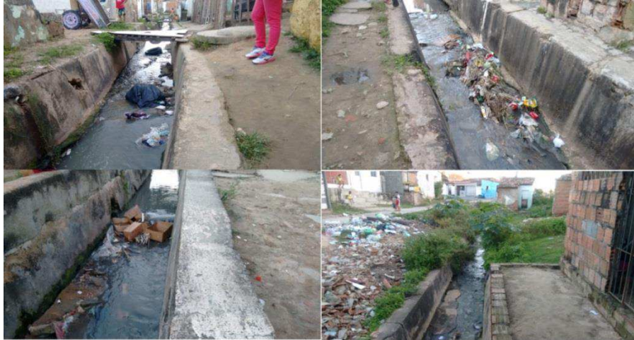
Figura 15 – Presença de resíduos sólidos no entorno e dentro do canal
