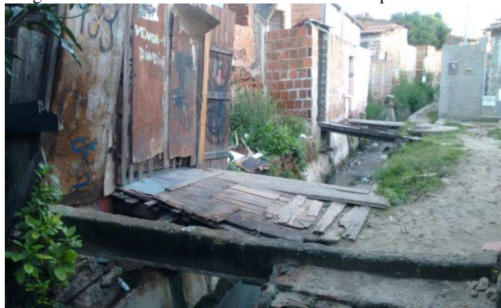
Figura 14 – Muros das casas construídos sobre a parede do canal
