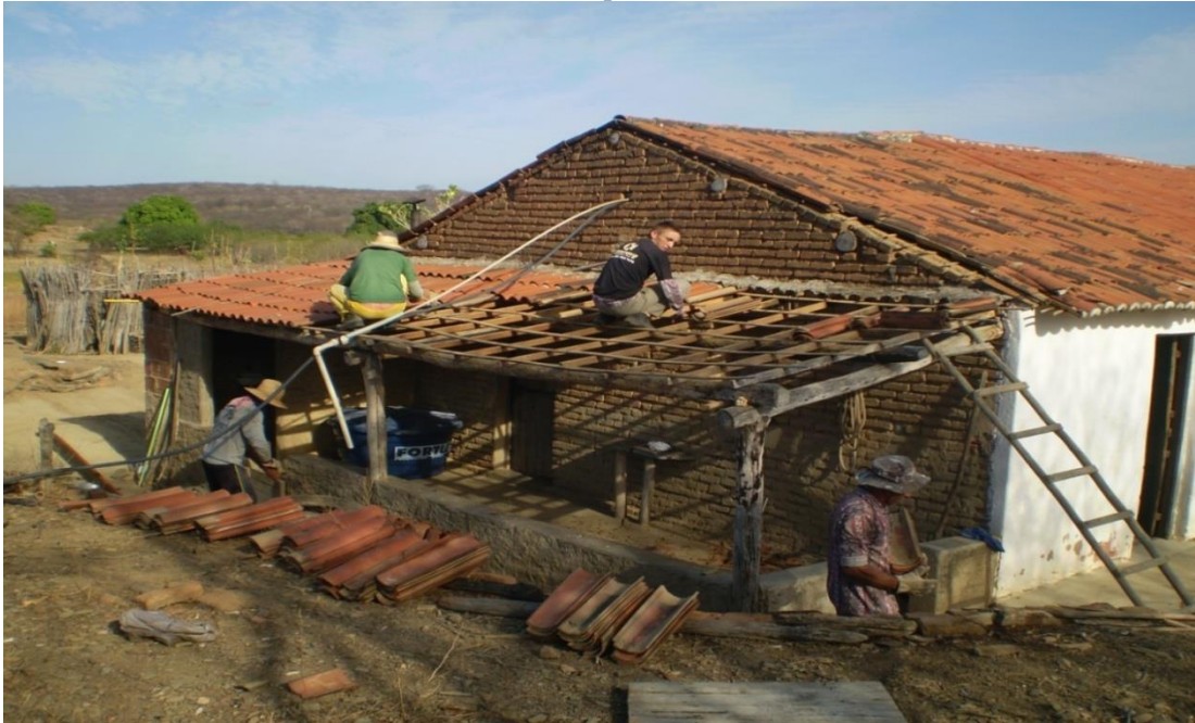
Figura 10 – Demolição de residências na comunidade rural do Sítio Cacaré para a execução do Projeto de Transposição
