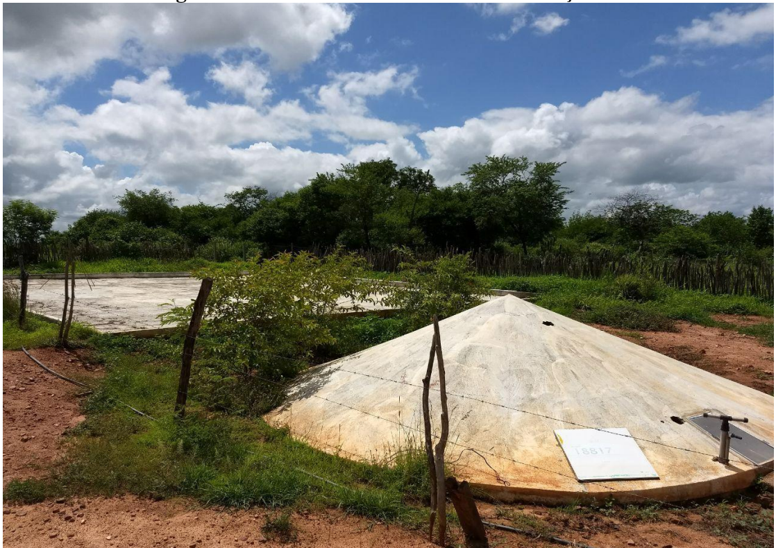
Figura 04: cisternas de Placa e cisterna Calçadão
