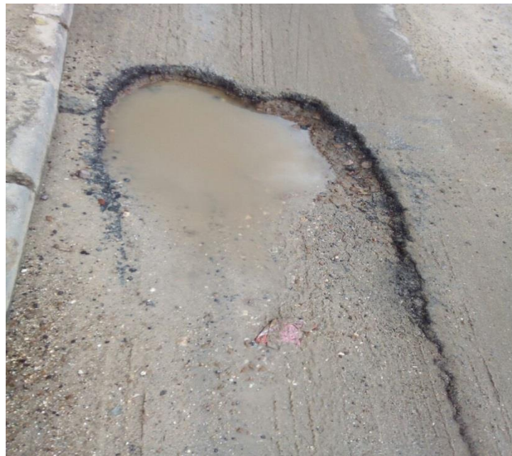
Figura 30: Panela ou Buraco.
