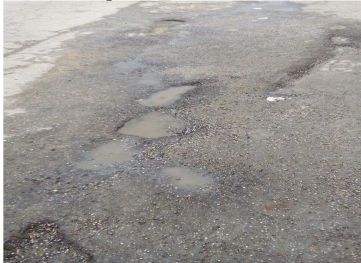
Figura 29: Panela ou Buraco.
