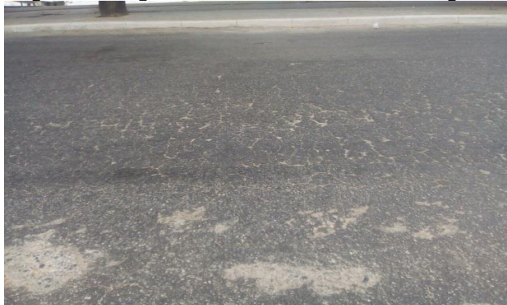
Figura 27: Desgaste associado com Trincas Interligadas.
