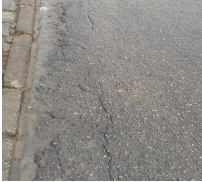
Figura 21: Trinca Longitudinal na Av. Manoel Tavares.
