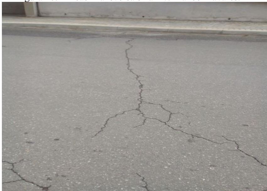
Figura 18: Trincas Transversais na Av. Manoel Tavares.
