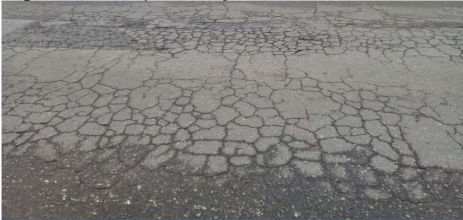
Figura 19: Trinca “tipo couro de jacaré” na Av. Manoel Tavares.
