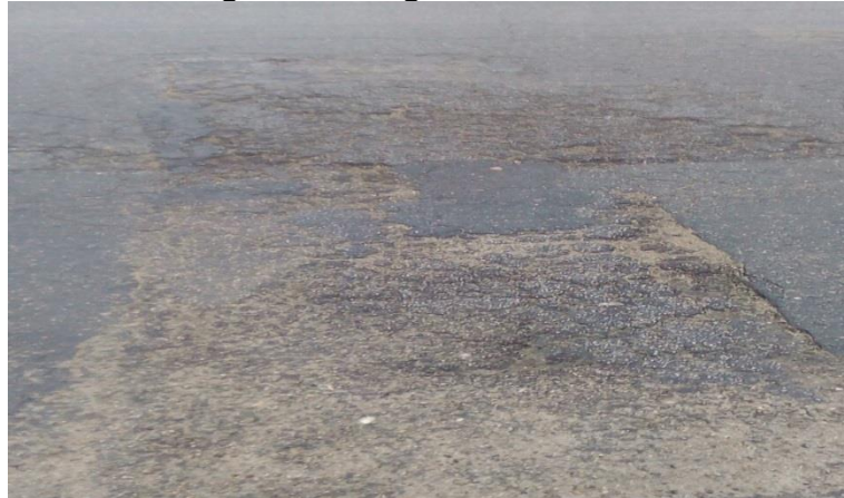
Figura 28: Desgaste e Remendos.
