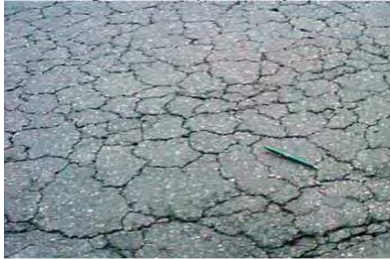
Figura 4: Trinca tipo “couro de jacaré”
