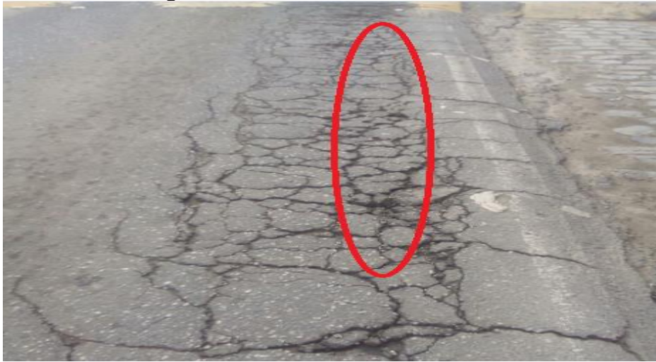
Figura 24: Afundamento na Av. Brasília.
