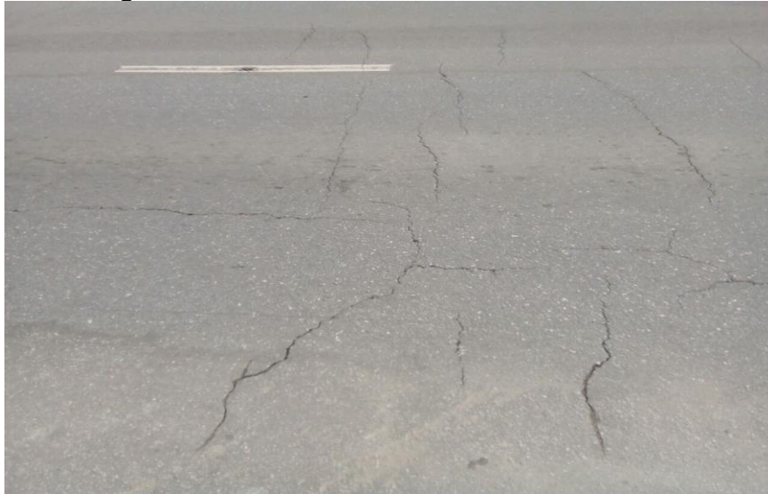
Figura 17: Trincas Transversais na Av. Brasília.
