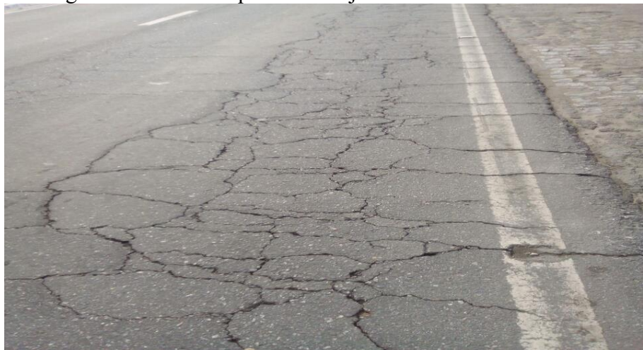
Figura 20: Trinca “tipo couro de jacaré” na Av. Brasília.
