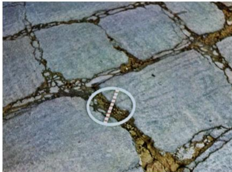
Figura 5: Trinca tipo “Bloco”
