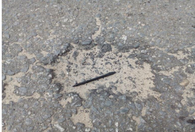
Figura 31: Panela na Av. Brasília.
