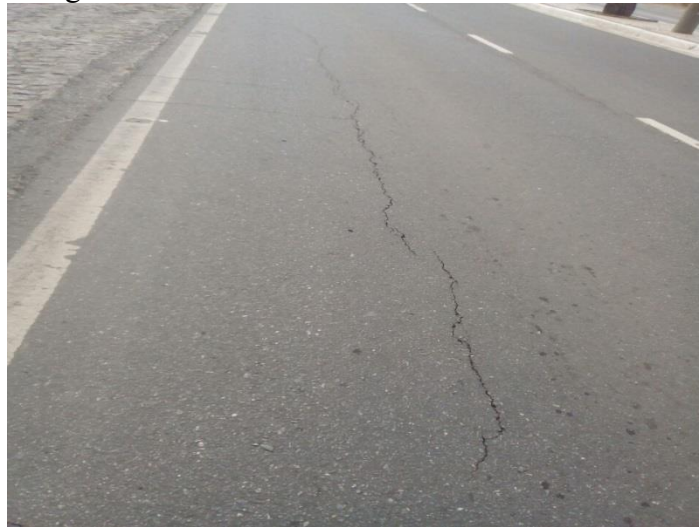
Figura 22: Trinca Transversal na Av. Brasília.
