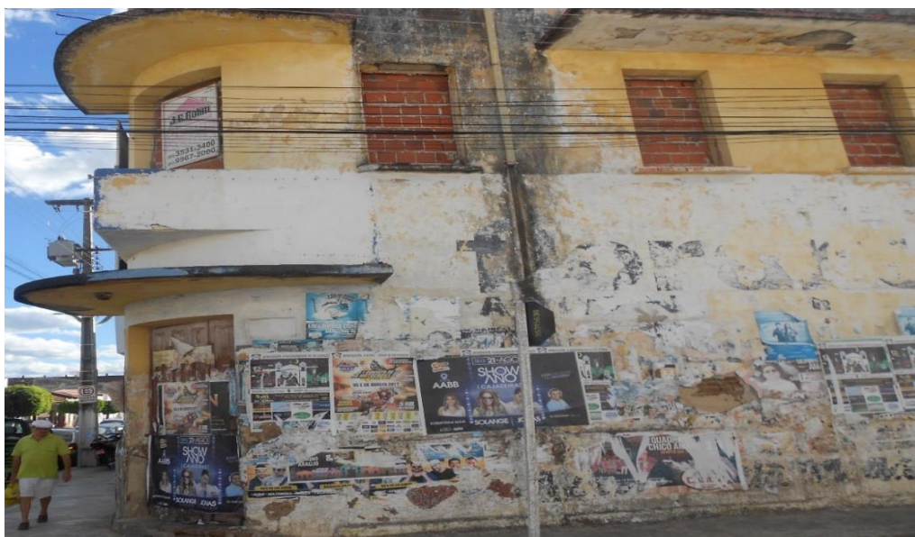
Foto 03: Prédio em ruínas com características Art déco. Fonte: ROCHA, Kassia Janny Gonçalves. Cajazeiras-PB (2017).
