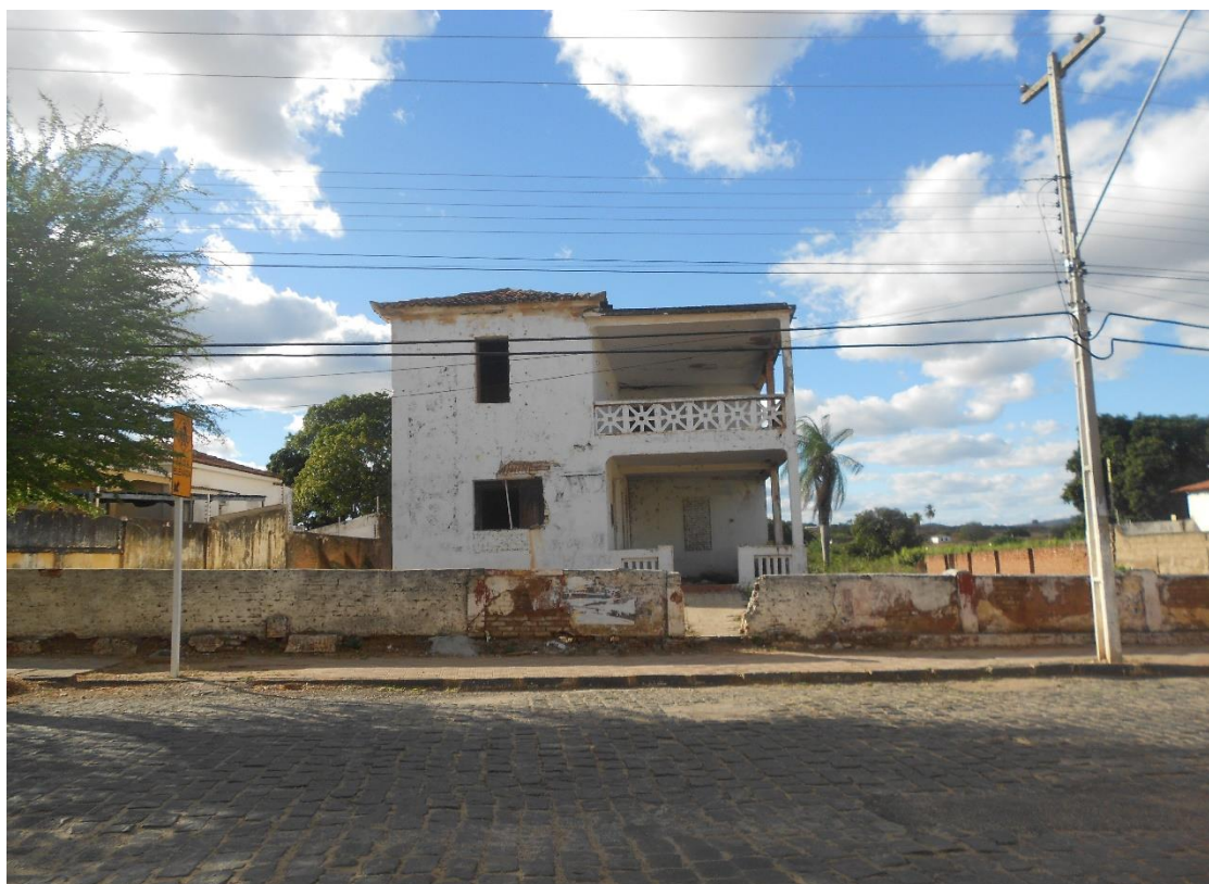
Foto 04: Casarão em ruínas.
