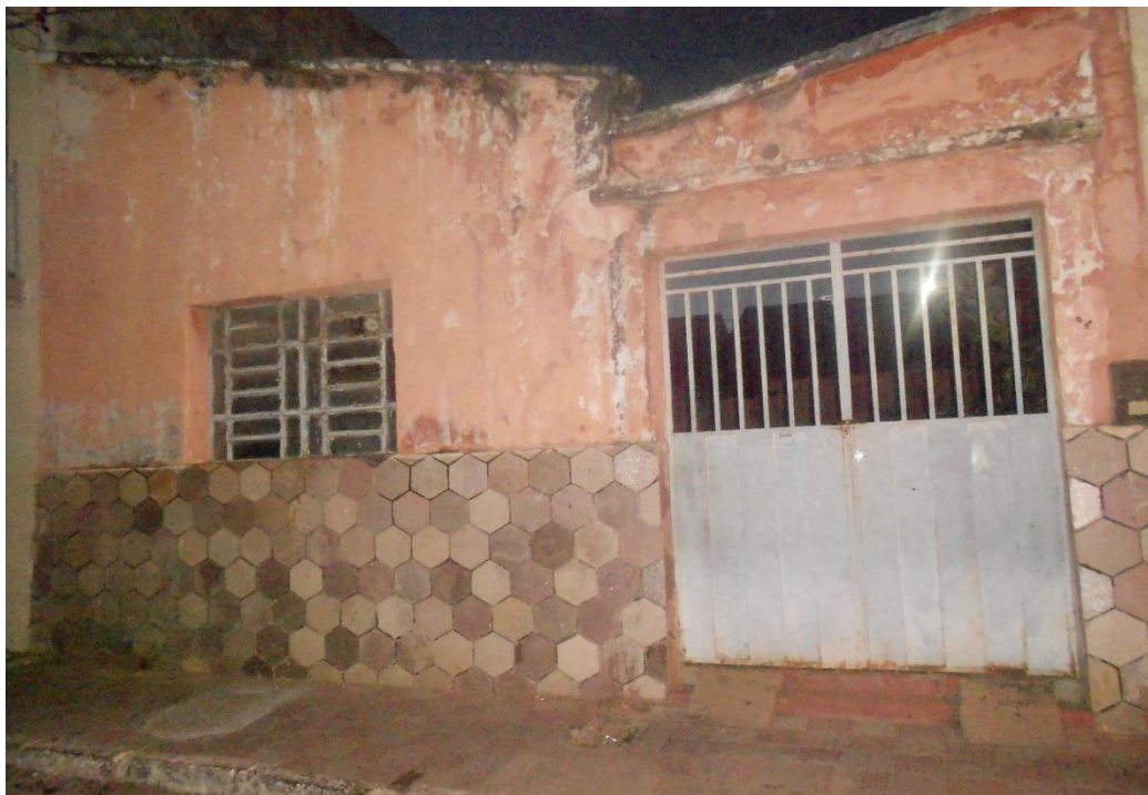
Casa nº 108 em situação de ruína, acumulando lixo, localizada na Rua Epifânio Sobreira. Foto: ROCHA, Kassia Janny Gonçalves, Cajazeiras-PB (2017).
