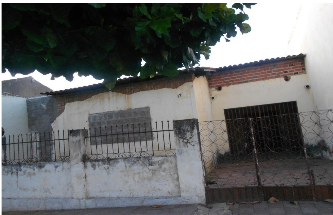
Casa nº 17, localizada na Rua Aprígio de Sá, encontra-se atualmente em ruínas e tendo janelas e portas tapadas com concreto para impedir a entrada de usuários de drogas. Foto: ROCHA, Kassia Janny Gonçalves, Cajazeiras-PB (2017).
