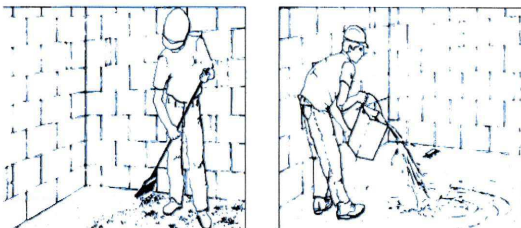
Figura 11. Remoção das partículas soltas e materiais pulverulentos utilizando vassouras duras e lavagem com água em abundância.
