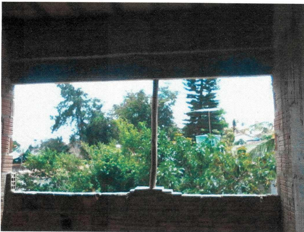
Figura 6 – Verga e escora em vão de janela.
