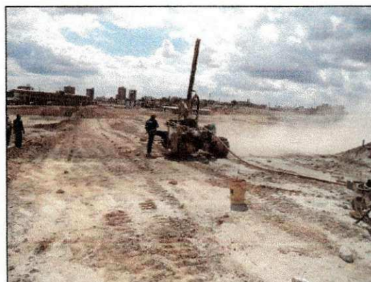
Continuação dos trabalhos de perfuração em rocha com auxílio da perfuratriz pneumática da DETEX. (imagem de 29/01/14)
