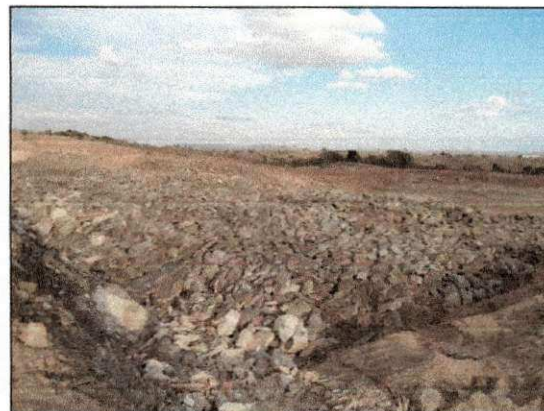
Desmonte de rocha decomposta com auxílio do rompedor hidráulico da RealMaq. (imagem de 10/01/14)
