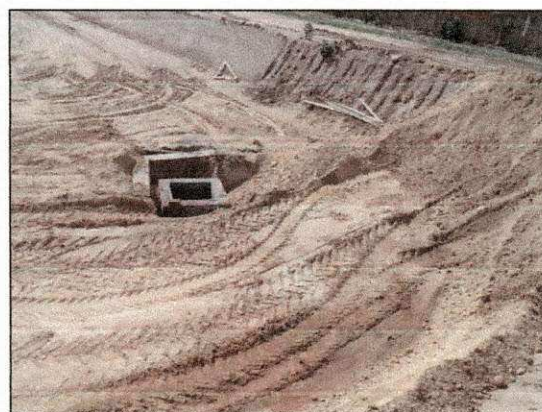
Caixa de inspeção de esgoto dos blocos operacionais. (imagem de 24/12)
