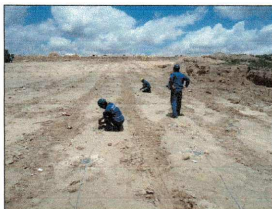
Operação de carregamento dos explosivos para a primeira detonação na área de escavação 01. (imagem de 14/11)
