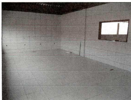
Assentamento da cerâmica de piso e paredes concluído, na cozinha do bloco do almoxarifado. (imagem de 17/01/14)
