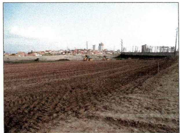
Compactação de material escavado na parte baixa do terreno próximo à antiga lagoa.
