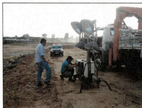
Instalação da torre de iluminação (xuxinha) para auxiliar os trabalhos de instalação de explosivos durante a noite. (imagem de 14/11)
