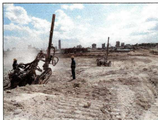
Chegada de mais uma perfuratriz para acelerar os trabalhos de perfuração em rocha para instalação de explosivos. (imagem de 13/12)
