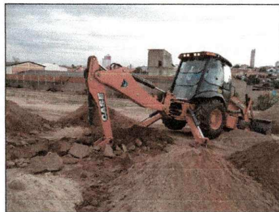
Escavação de vala para construção de PV para ligação de esgoto dos blocos operacionais. (imagem de 17/12)
