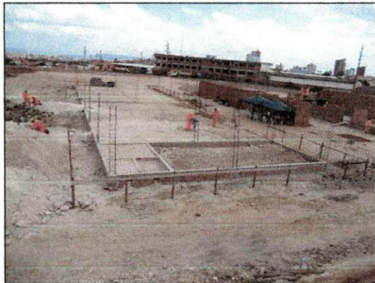
Execução do aterro do caixão com empréstimo de solo do bloco do almoxarifado. (imagem de 14/11)
