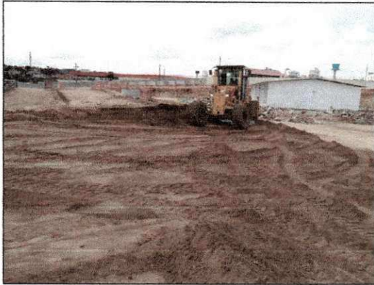
Regularização do acesso à obra com auxílio da motoniveladora da COMPECC. (imagem de 07/02/14)
