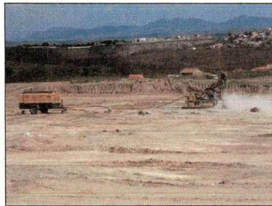
Perfuração de rocha com auxílio de perfuratriz da DETEX para desmonte de rocha dura com explosivos. (imagem de 29/10)
