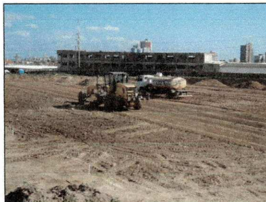
Trabalhos finais de terraplenagem na área onde serão instalados os blocos operacionais. (imagem de 03/10, conclusão em 09/10)
