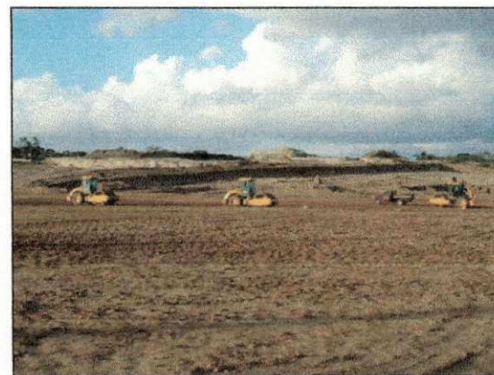
Compactação de material lançado e espalhado sobre a parte 2 do dreno, próximo aos platôs 1 e 2. (16/10)
