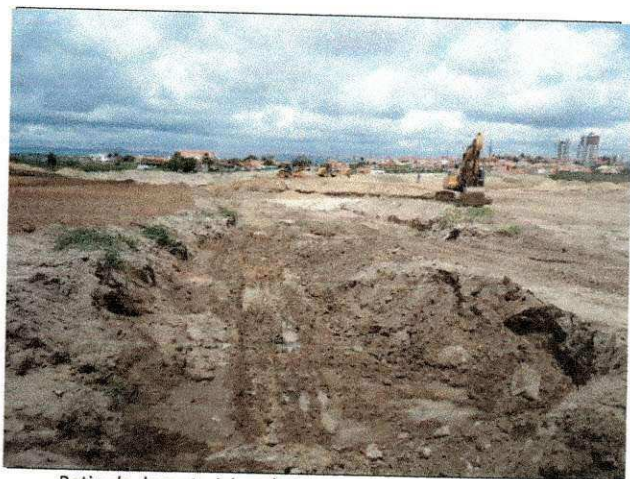
Retirada de material orgânico e lama para continuação da execução do dreno.
