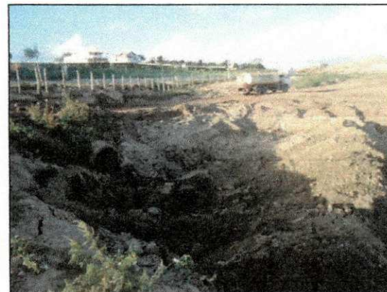
Trabalhos finais de retirada de solo argiloso da parte 1 do talvegue para continuação do lançamento de material arenoso que compõe o dreno. (imagem de 16/10)
