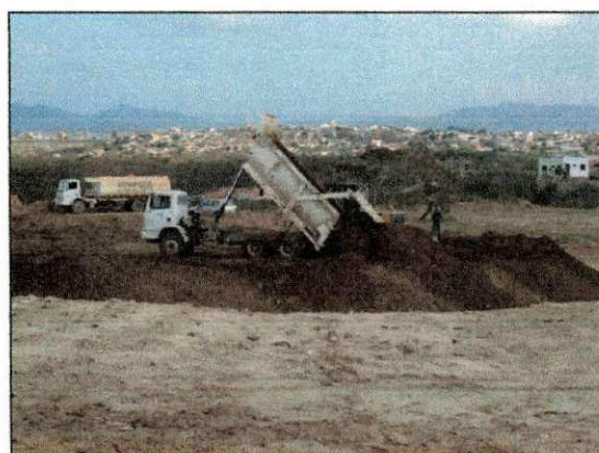
Lançamento de material de bota-fora para abafamento da detonação na área de escavação 01. (imagem de 14/11)
