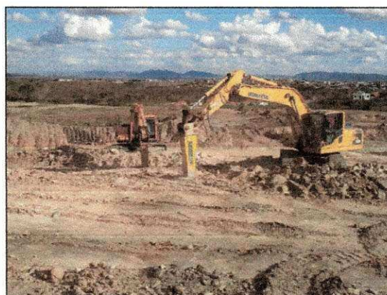
Desmorte de rocha decomposta com auxílio dos rompedores hidráulicos da RealMaq e Detrol. (imagem de 02/12)
