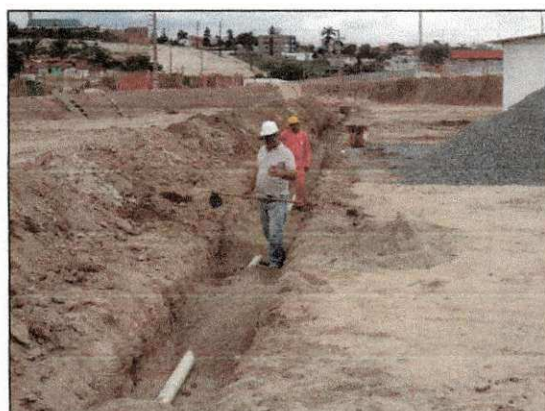
Assentamento do tubo de drenagem do esgoto do bloco administrativo 02. (imagem de 21/02/14)
