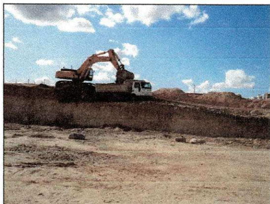
Escavação inicial para execução futura do taludamento para a cortina de contenção do aterro. (imagem de 02/12)
