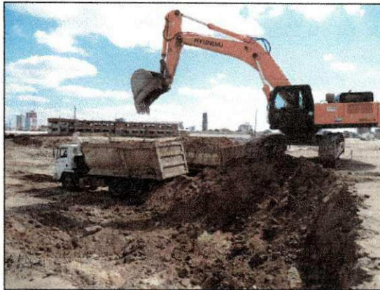
Escavação e transporte de material escavado na área do platô 6. (imagem de 29/10)
