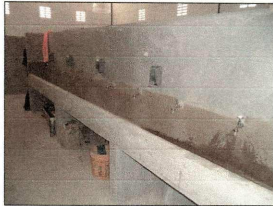
Finalização da instalação das louças e metais do bloco dos vestiários. (imagem de 17/01/14)
