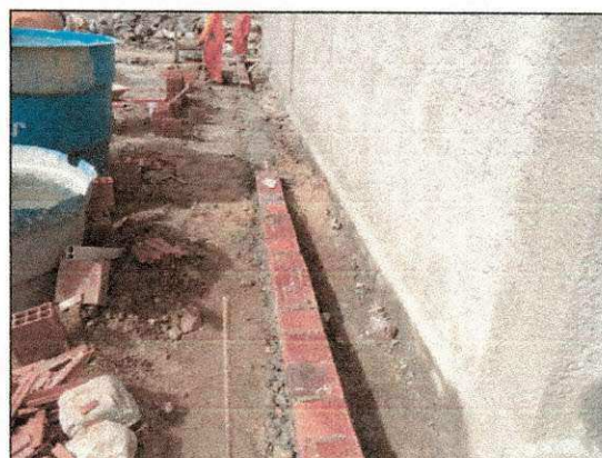
Continuação da execução das calçadas de contorno bloco dos vestiários. (imagem de 24/12)
