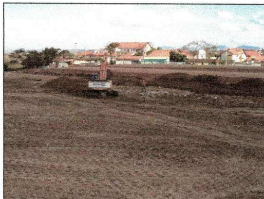
Separação de pedras grandes lançadas juntas com o material proveniente das detonações com explosivos. (imagem de 02/12)
