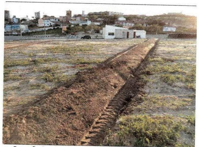
Execução de vala utilizando motoniveladora para drenagem da água que escoa no terreno do bloco administrativo.
