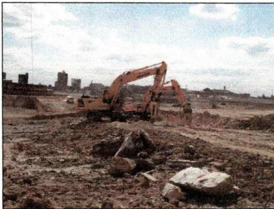
Desmorte de rocha decomposta com auxílio dos rompedores hidráulicos da Detrol e RealMaq. (imagem de 27/11)
