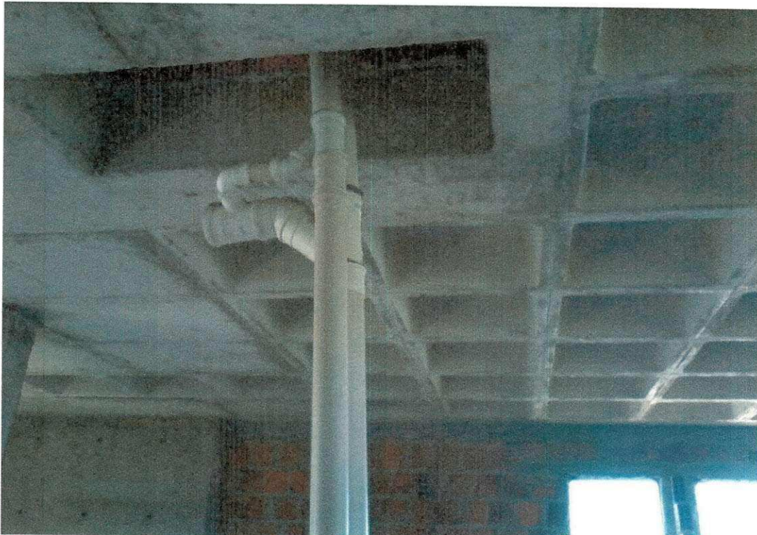
Figura 9: Instalação sanitária, tubo de queda e coluna de ventilação no edifício Solar Veronese.
