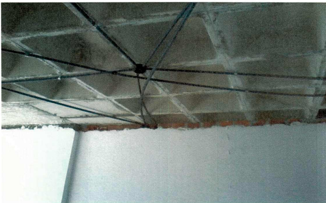
Figura 6: instalação elétrica e revestimento de gesso no apartamento 01 do pavimento - tipo 4, Solar Veronese.
