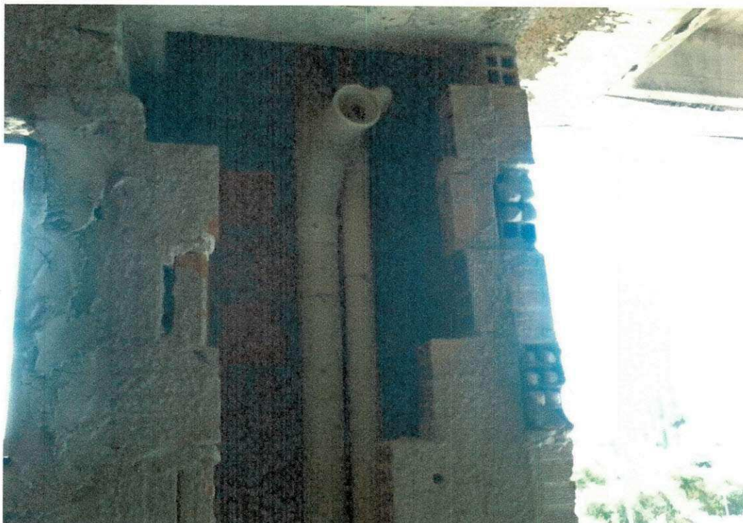
Figura 10: Tubulação de esgoto em apartamento do Solar Veronese.
