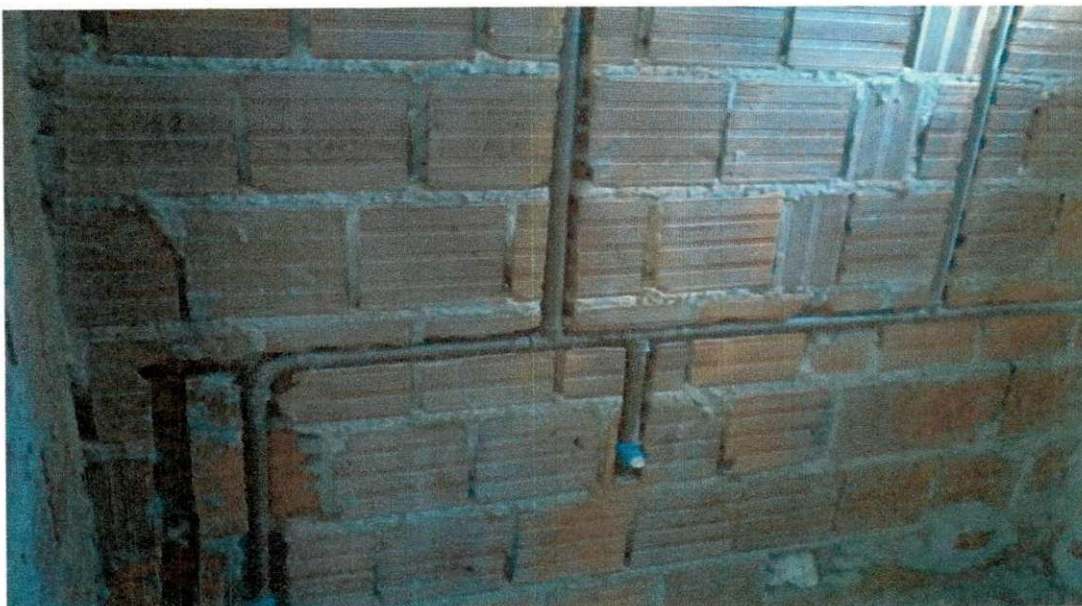
Figura 8: Rasgos em alvenaria e tubulação de água fria em apartamento do Solar Veronese.
