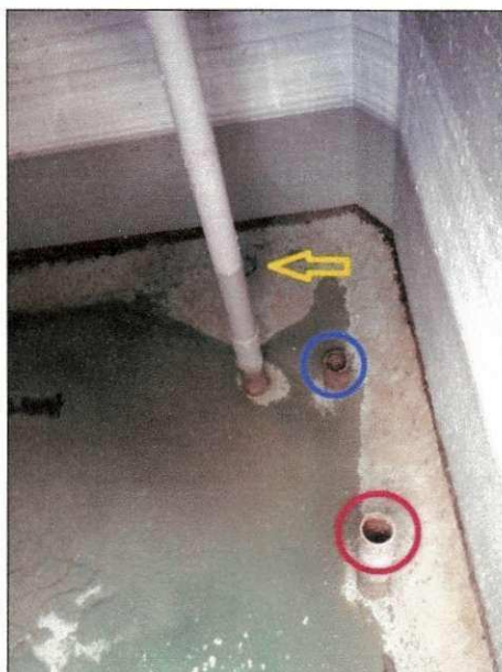
Figura 29- Detalhe das tubulações de abastecimento da rede e limpeza do reservatório.
