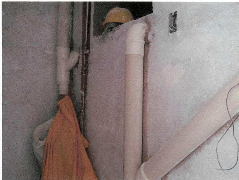
Figura 11- À esquerda, uma das tubulações que alimentam as cisternas.
