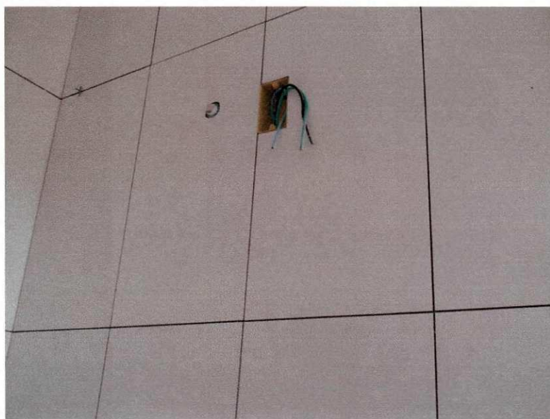
Figura 4-Detalhe da tomada para chuveiro elétrico.
