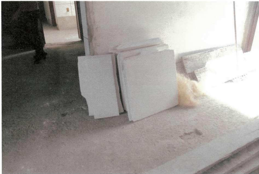
Figura 31- Placas de gesso para acabamento dos tetos.
