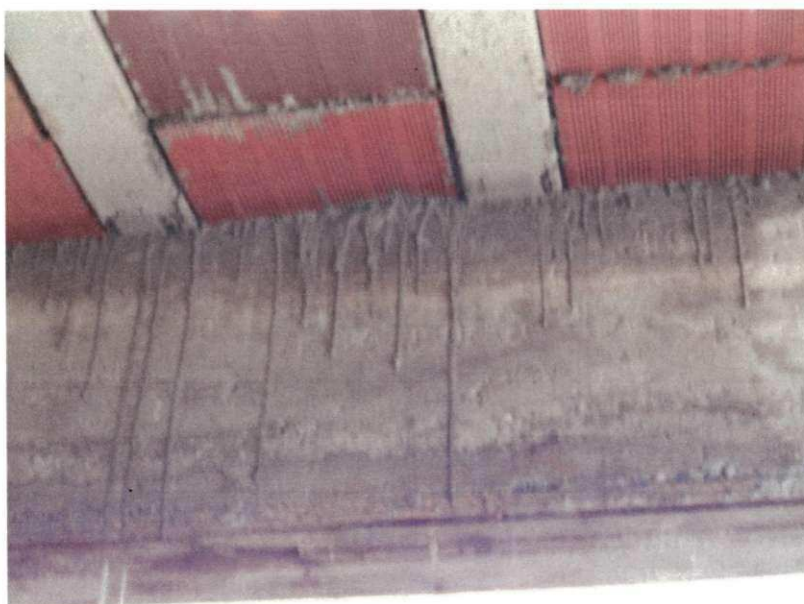
Figura 52- Perda de finos e de nata de cimento durante a concretagem.
