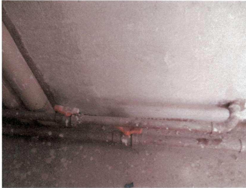
Figura 12- Tubulações que interligam as cisternas.
