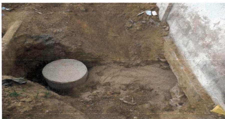
Figura 33 - Caixa de passagem da escola para caixa de esgoto da rua.
