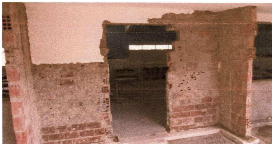
Figura 52 - Retirado do conjunto das portas- padronização para acessibilidade.
