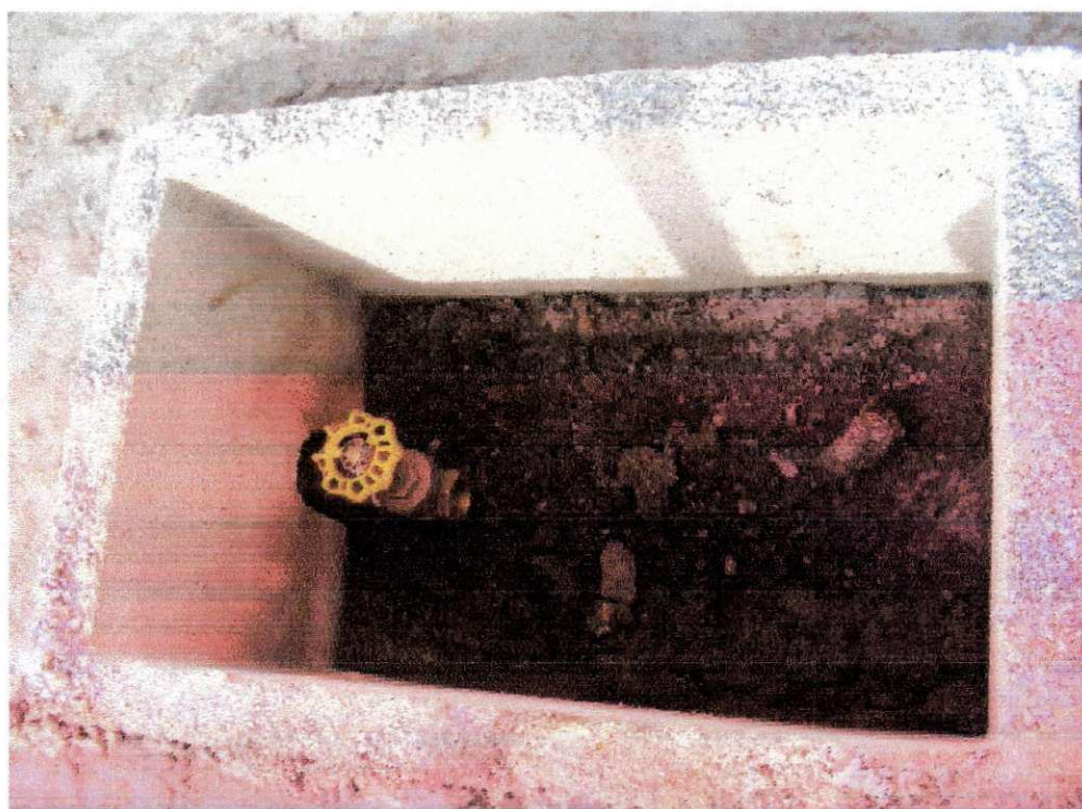
Figura 17 - Caixa de ligação de água com registro instalado
