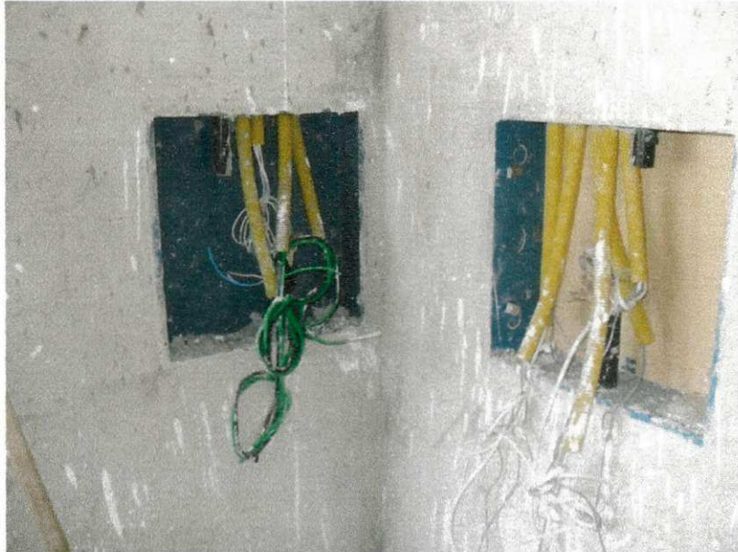
Foto 17 - Caixas de passagem elétrica, de TV e telefone
