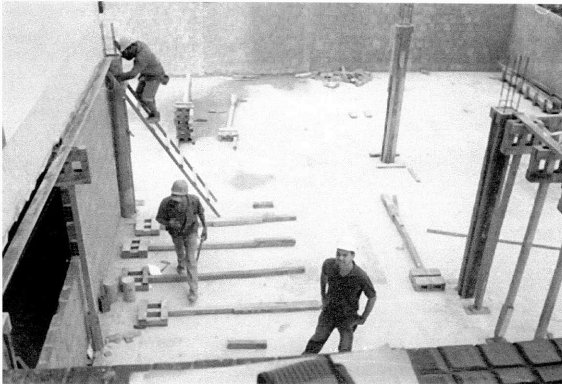
Foto 1: Colocação das escoras da Laje do Deck Autor da Foto: Leonardo Eudes
