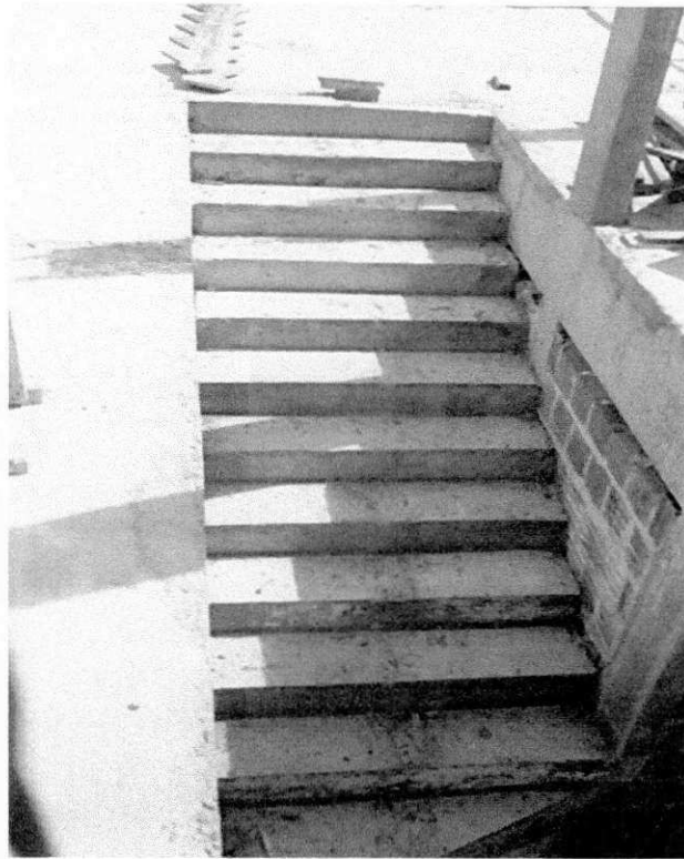
Foto 6: Escada do Hall de Entrada depois de Concretada Autor da Foto: Leonardo Eudes
