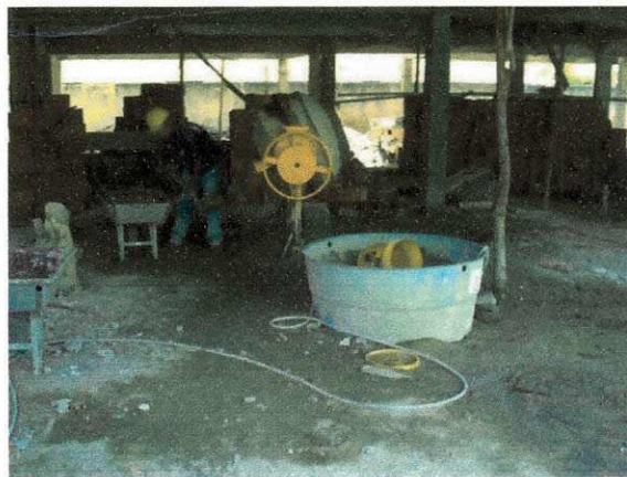
Figura 2.0- Central de produção de concreto e argamassa
