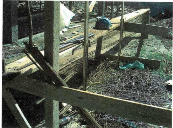
Figura 2.3 – Bancada de dobramento
