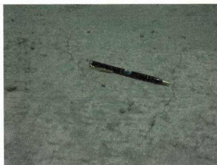
Fig. 2.41 – Fissuras de retração
