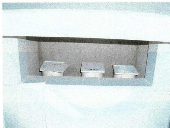
Figura 3 – Tubos de ventilação
