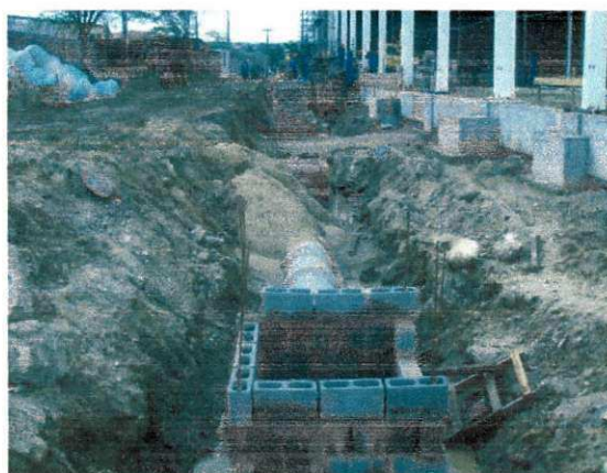
Figura 18 – Manilhas e poços de visita para drenagem pluvial (Fonte: Arquivo pessoal)
