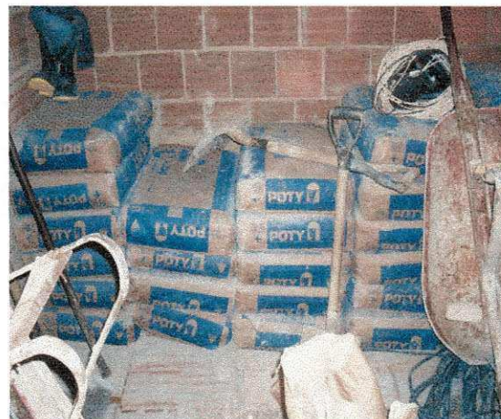
Armazenamento do cimento
