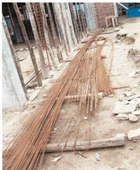
Vergalhões levemente oxidados
