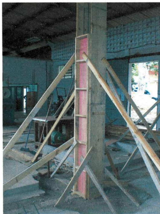
Figura 8 - Fôrma de pilar tipo paschal escorada
