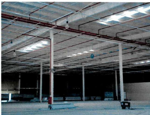
Figura 18 - Tubulação de ferro galvanizado – combate a incêndio
