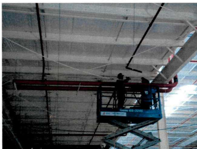
Figura 17 - Tubulação de ferro galvanizado – combate a incêndio
