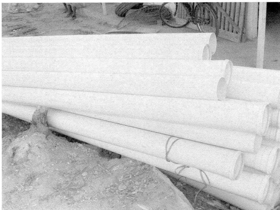
FIGURA 14 – Tubos em PVC utilizados na rede de drenagem.
