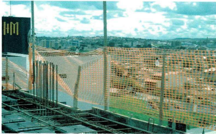
Figura 5.1 – Plataforma de proteção
