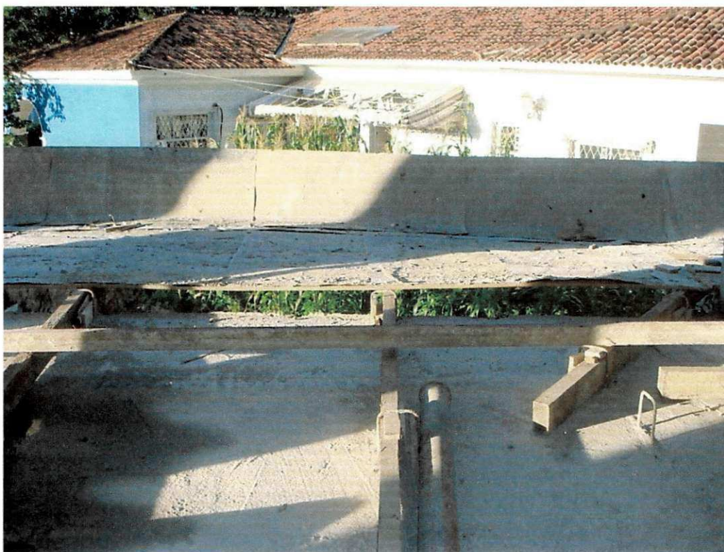
Foto 27 – Bandeja de proteção
