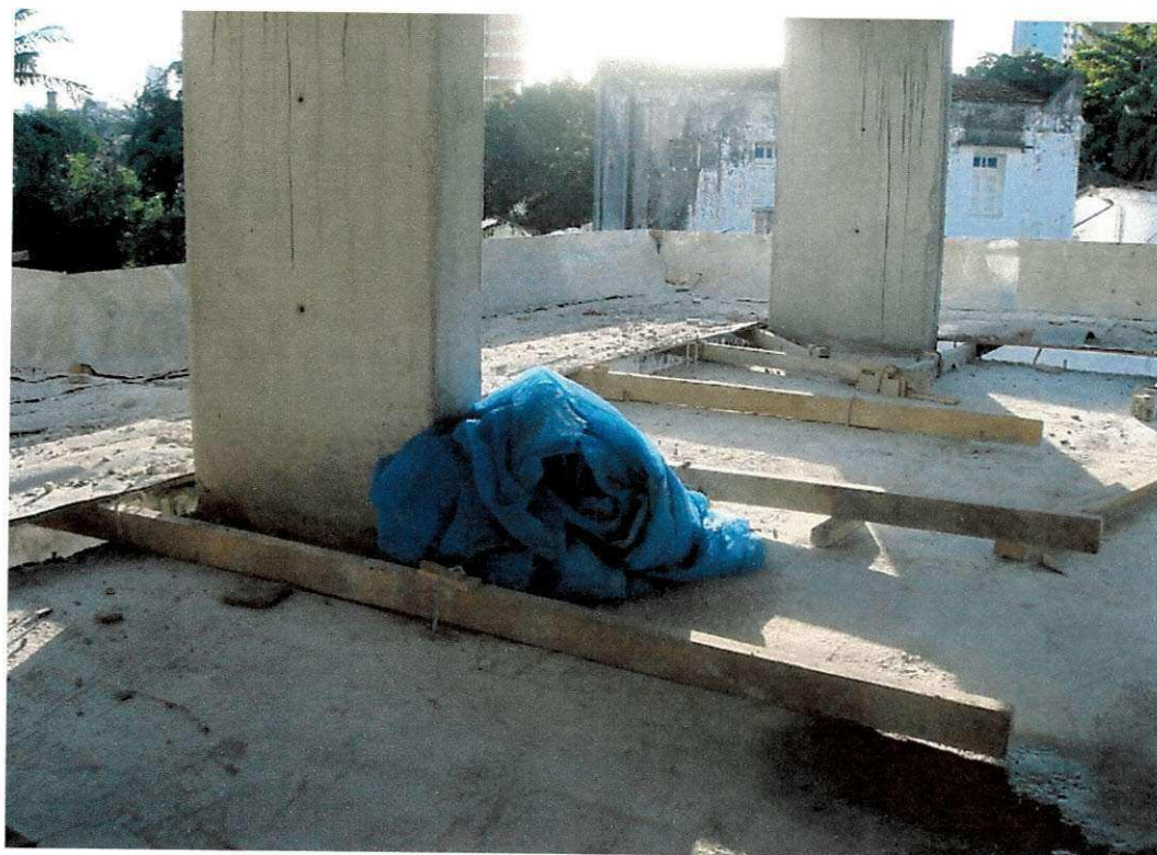
Foto 28 – Bandeja de proteção
