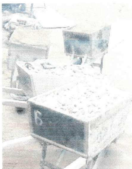
FIG. 10 - PADIOLAS DE CONCRETO
