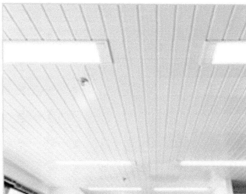
Foto 32 – Forro em PVC
